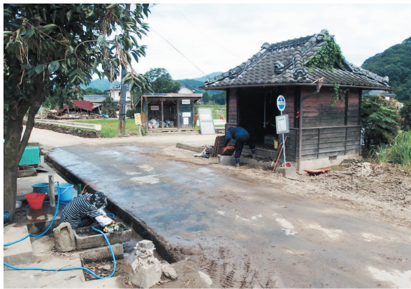
図4 大柿観音堂(人吉市中神町大柿)．ボランティア 3 名で堂内の泥出しと掃除が行われた（撮影：2020 年 8 月 1 日）。
