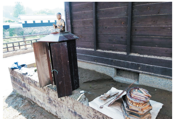
図10 新町地藏堂（人吉市新町）。泥水に浸かって一部破損した地藏像（撮影：2020年7月19日）。
