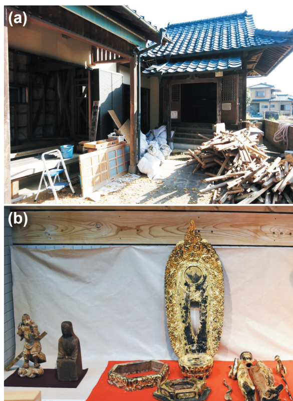
図8 湯元観音堂(人吉市温泉町)。(a) 大規模半壊した観音堂、(b) 破損してバラバラ状態となった御本尊(聖観音立像)(撮影:2020年10月17日)。
