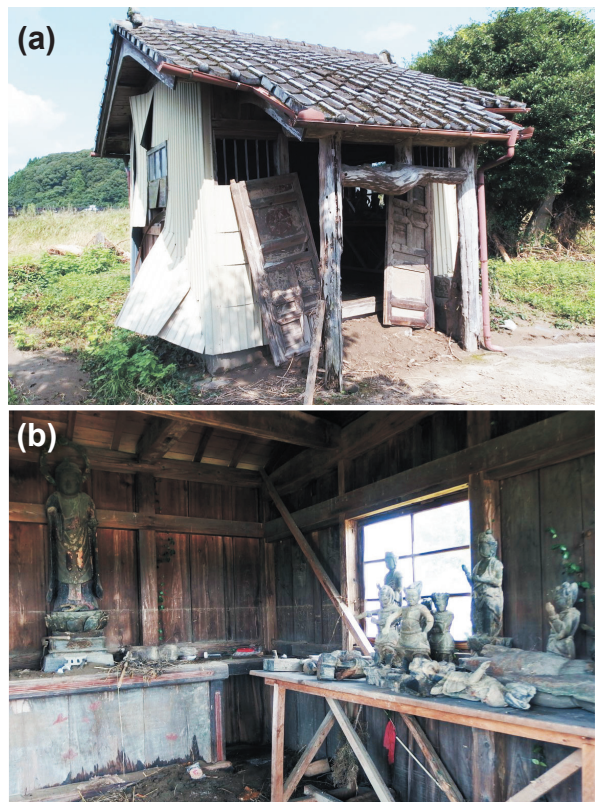
図 12 ハツ田薬師堂（相良村柳瀬字中村）。 (a) 被災した堂，(b) 堂内（撮影：2020 年 7 月 17 日）。
