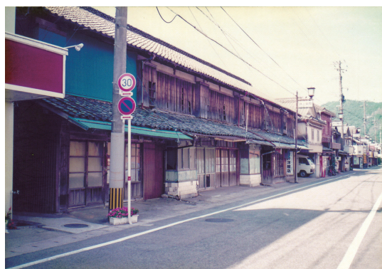
写真 4 は、七軒長屋と呼ばれた建物で、大正時代の建築である。かつては数軒の商店が入居していたが、8 年頃は洋服の仕立て業者のみがここで営業していた。既に老朽化が進んでおり、現在建物は解体されている。
