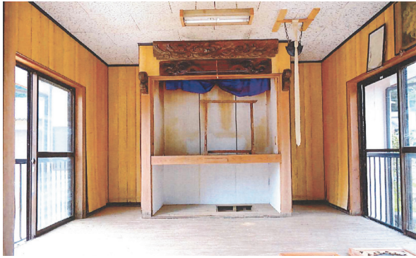
図8 被災した八代市坂本町大門地区の大門観音堂内部。(撮影：2020年9月23日)
