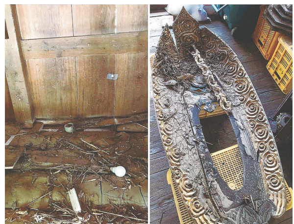
図5 左：堂内に入り込んで溜まった泥や木々の破片，右：本尊光背に厚く付着した泥や木屑。(撮影：2020年8月12日)
