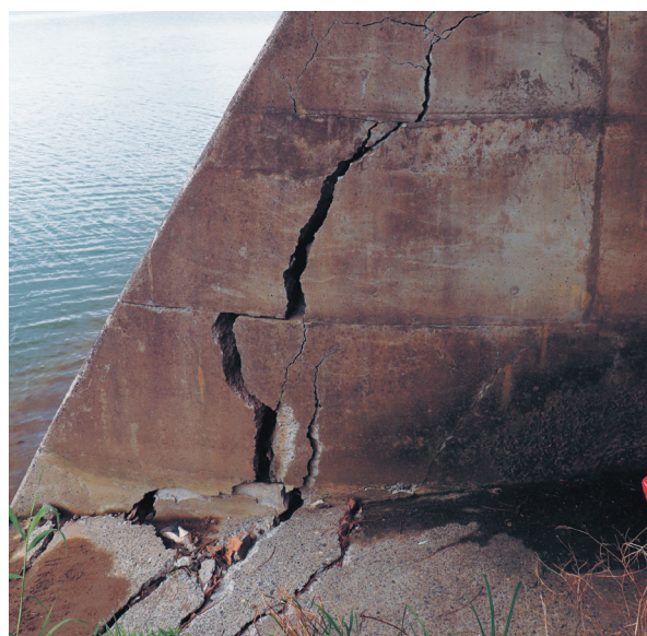
図 19 カルバートンネルのクラック (2021 年 8 月 9 日撮影)
