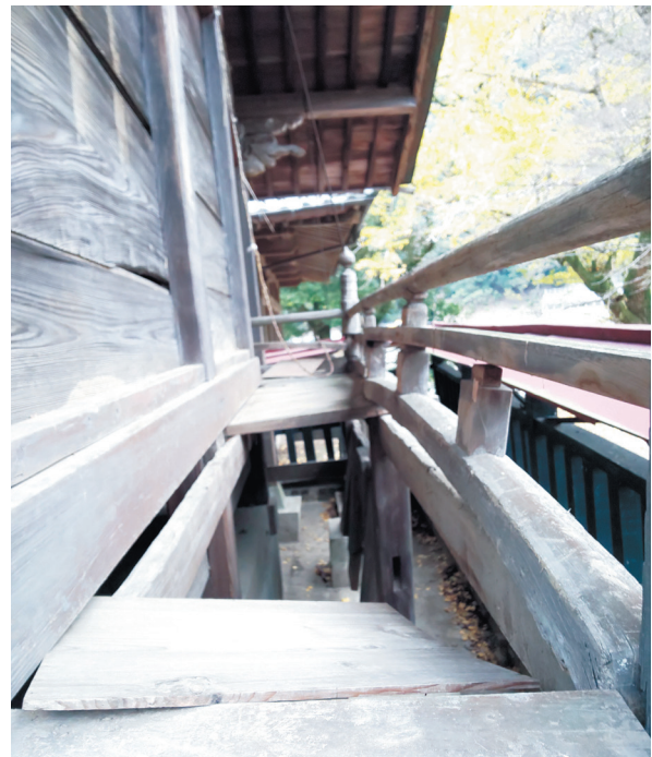
図6 中津道阿蘇神社本殿の破損状況。 (2020年11月22日撮影)
