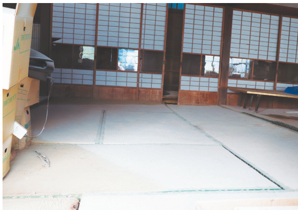
図21 被災したJAやつしろ坂本支所の和館部分。 (2021年8月7日撮影)
