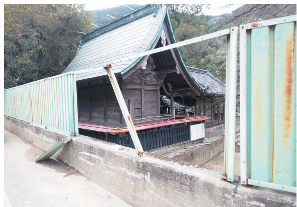
図3 破損したフェンス越しの中津道阿蘇神社。 (2021年3月13日撮影)
